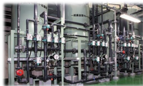
浸出水処理施設
