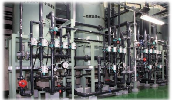
浸出水処理施設
